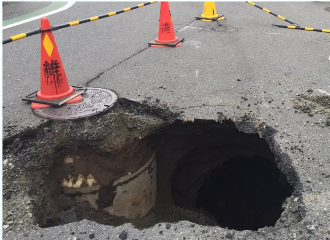
実際の道路陥没
