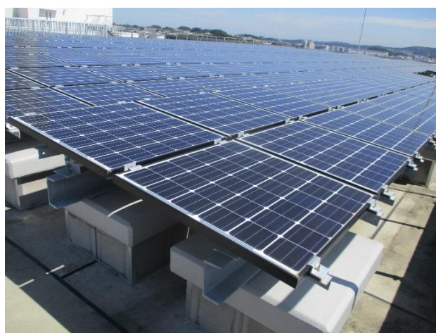
◆市役所本庁舎 太陽光発電システム
