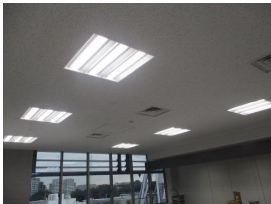
◆市役所本庁舎 LED照明
