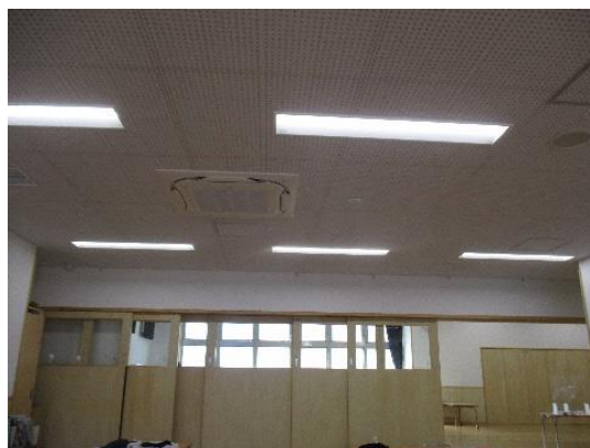
◆藤が岡保育園 LED照明
