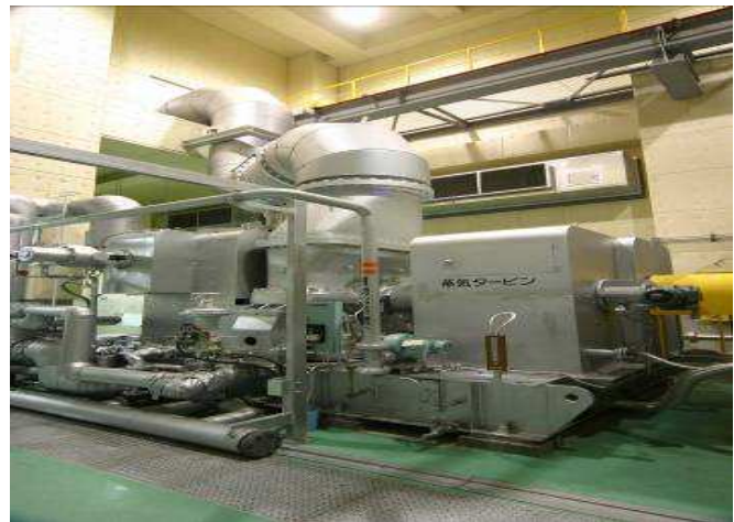
【蒸気タービン & 発電機】
