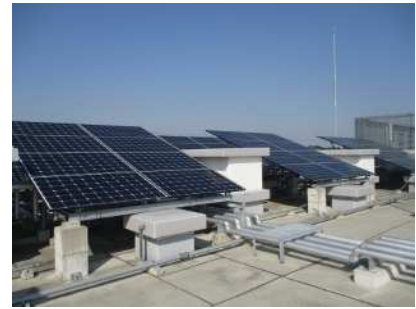
【藤沢市民病院に導入した太陽光発電システム(20 kW)】
