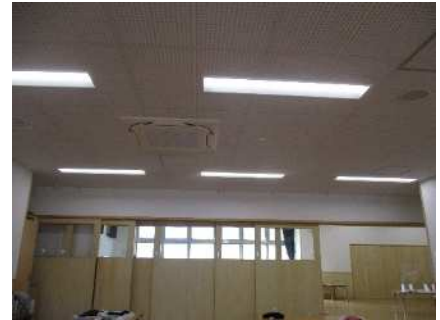
【藤が岡保育園に導入した LED 照明】
