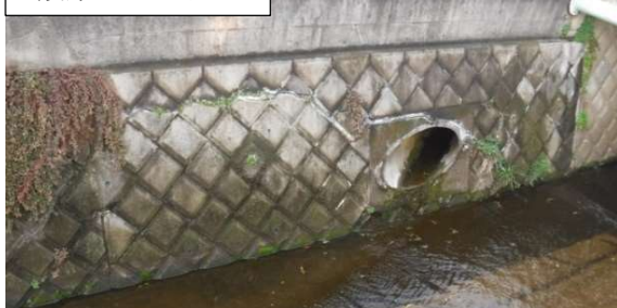
護岸 クラック
