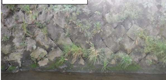
雑割石積 目地欠損
