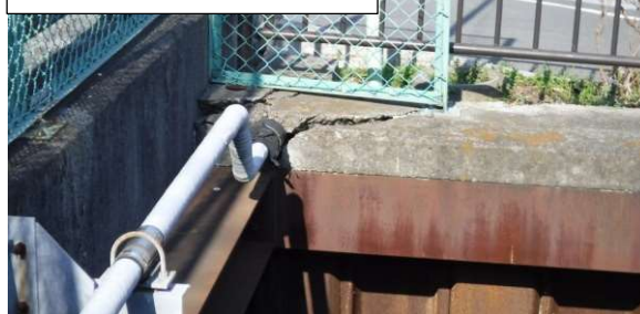
笠コンクリート 欠損
